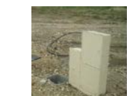
Coffret de branchement électricité (projet)
