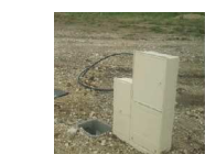
Coffret de branchement électricité (projet)
