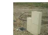
Coffret de branchement électricité (projet)
