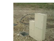
Coffret de branchement électricité (projet)
