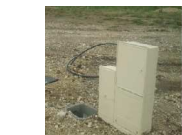
Coffret de branchement électricité (projet)
