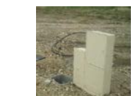
Coffret de branchement électrique (projet)
