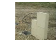
Coffret de branchement électricité (projet)
